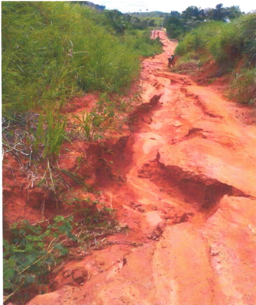
Foto 01: Vicinal Planalto (mato se sobrepondo a estrada, deslizamento de leito).
