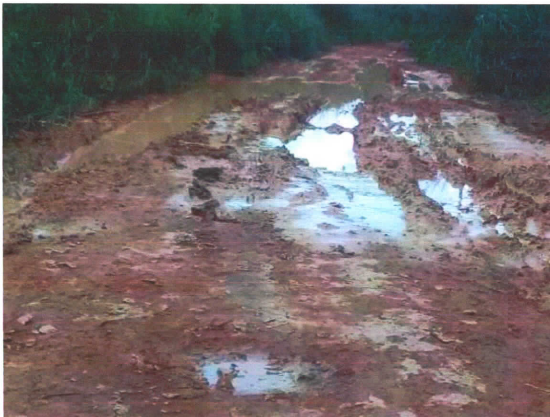
Foto 04: Vicinal Planalto (mato se sobrepondo a estrada, material inadequado, poças).
