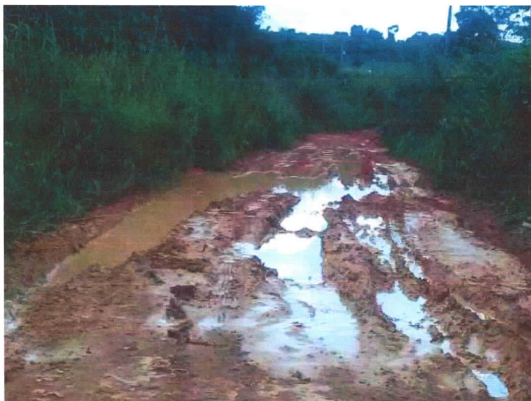
Foto 03: Vicinal Planalto (mato se sobrepondo a estrada, material inadequado, poças).
